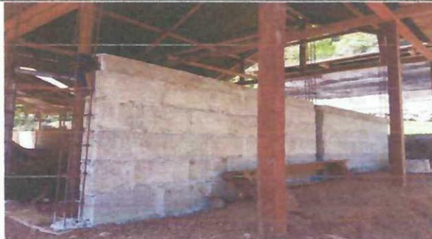
Foto 2: Se necesita colocar estructura de techo
