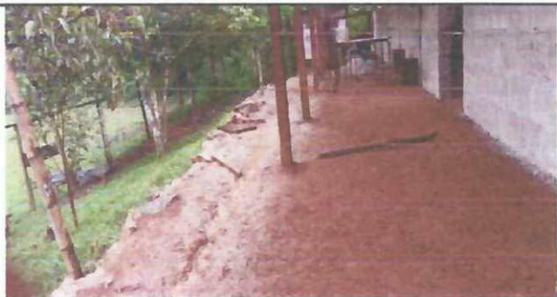
Foto 5: Se necesita el piso del corredor
