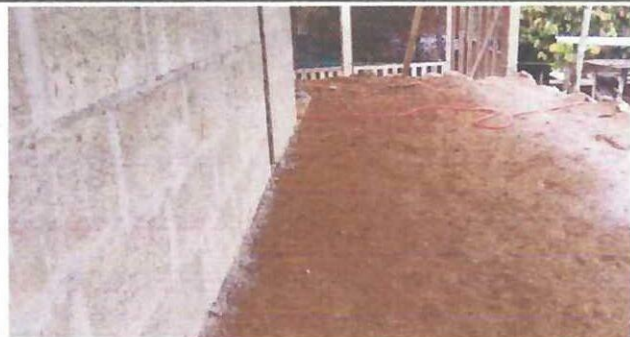
Foto 1: Se necesita fundir el piso del corredor
